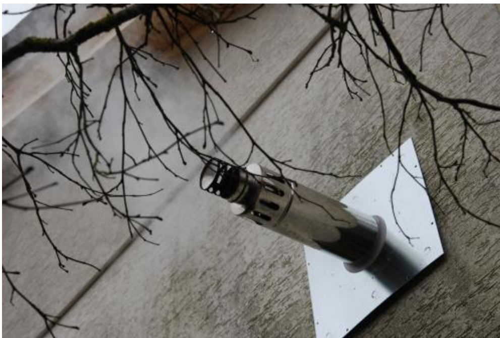
La nouvelle cheminée "basse consommation" (©JL)
