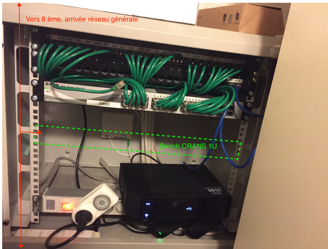
FIGURE 3 – Baie de brassage
